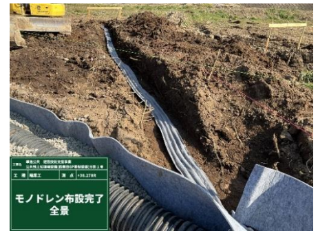
あんきょはいすい 暗渠排水の整備状況
