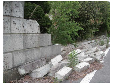
地震により石塀が倒壊
