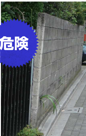
傾いている危ない塀
