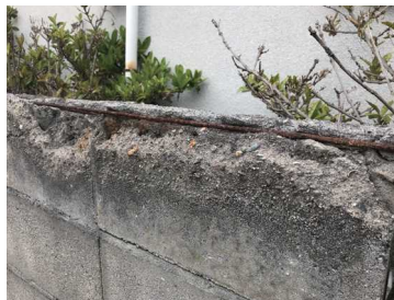
割れや鉄筋の露出がみられる塀
