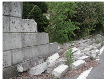
地震により石塀が倒壊
