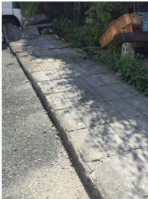
地震によりブロック塀が倒壊
