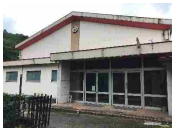
老朽化した体育館
