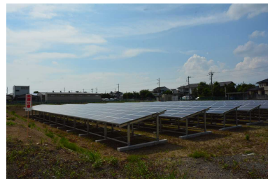
▲太陽光発電施設
