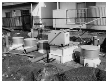
▲大型合併浄化槽
