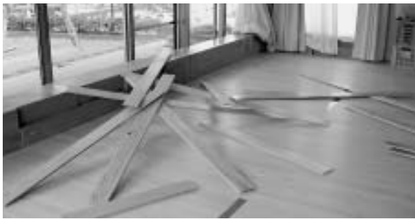
東町ちえのみ保育園で落下した天井板
