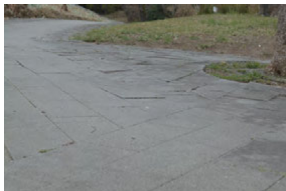
■写真 131 散策路石畳の劣化（ゾーンV）
