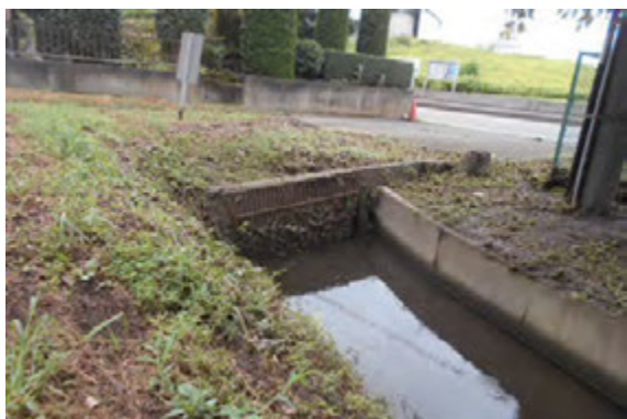
■写真 128 洪水の一因となる鹿の川沼への暗渠への取り入れ口（ゾーンⅥ）
