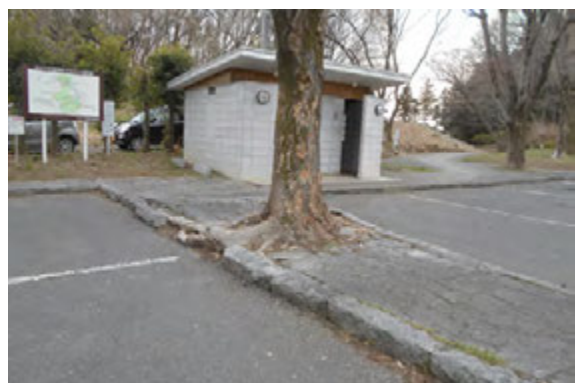
■写真 132 植栽による縁石の劣化（ゾーンV）
