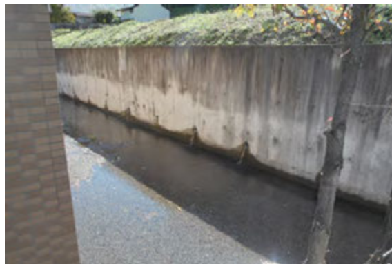
■写真 185 平成 29 年 10 月の台風による 史跡側からの湧水
