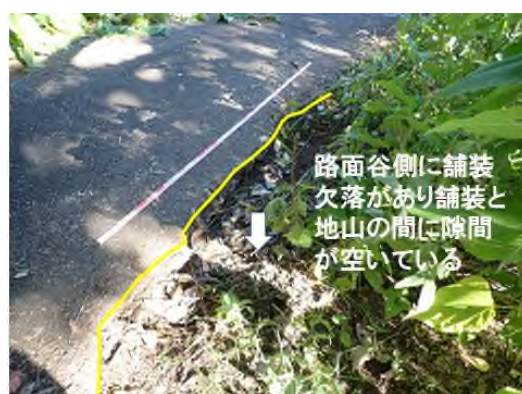
写真 5-2-4 舗装と地山との間の隙間
