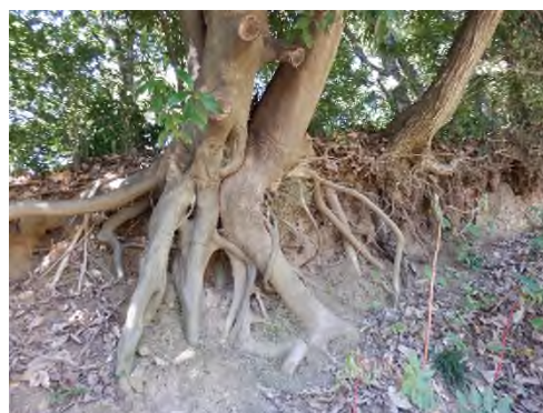
写真 3-3-11 根がむき出しとなった樹木
