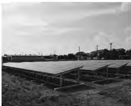
雨水調整池の太陽光パネル
